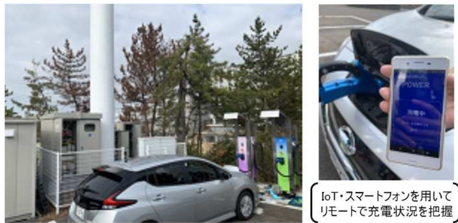
図2 直流EV給電装置
